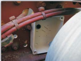
Instalación caja sensores
